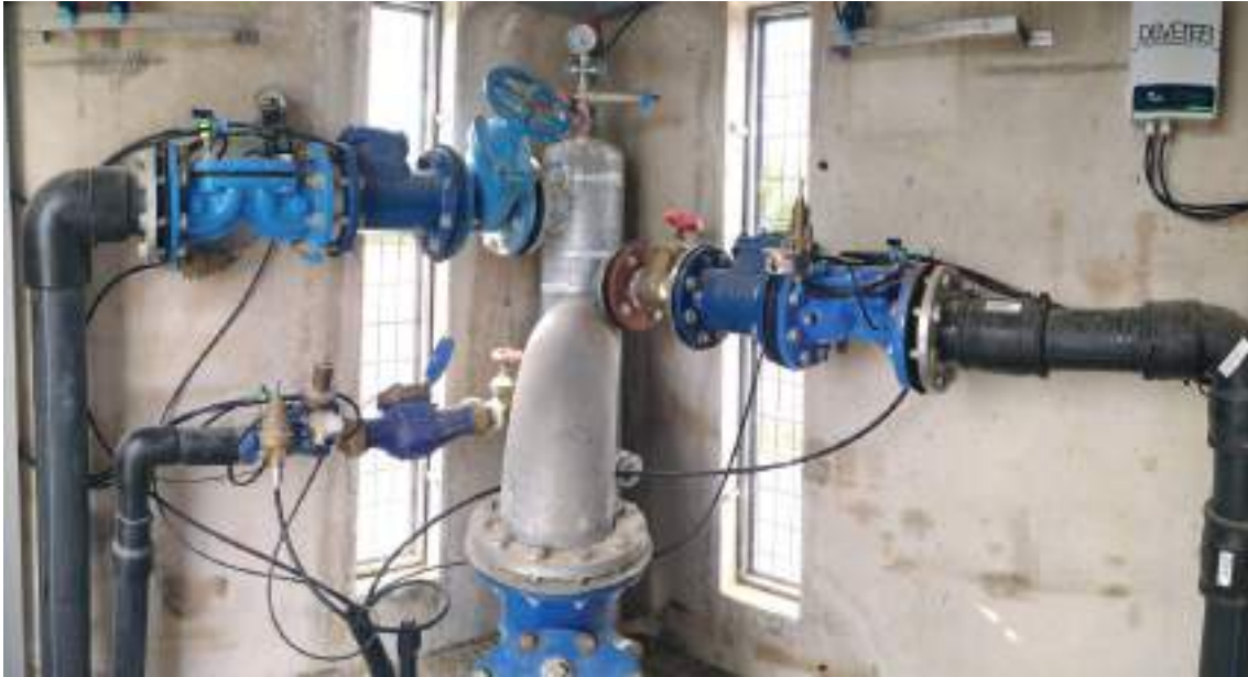
Figura 26. Vista de l'interior d'un hidrant compartit per tres propietaris, amb el dispositiu de telegestió.
