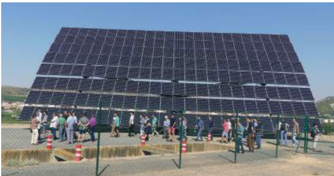
Figura 34. Ús de l'energia fotovoltaica en el regadiu (exemple del canal Algerrí-Balaguer).
